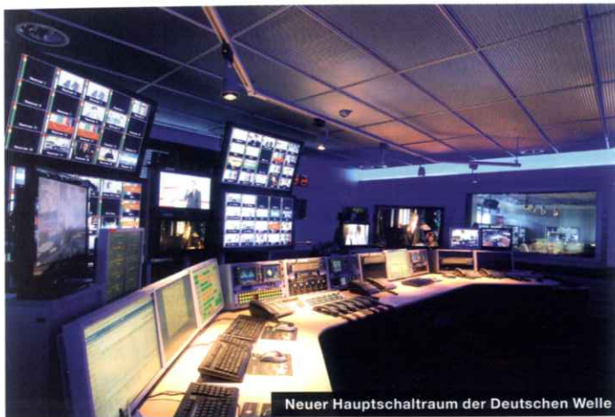
Neuer Hauptschaltraum der Deutschen Welle
